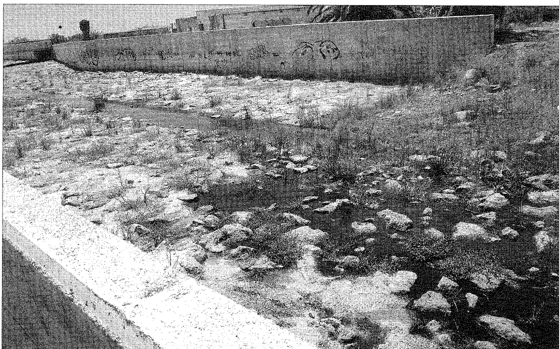
Las aguas fecales anegaron un tramo del barranco tras romperse la canalización. LEVANTE-EMV
